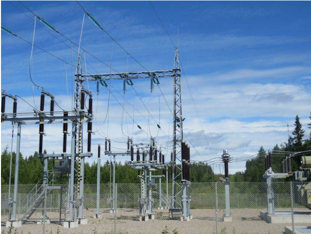
Kuva 25. Pihtiputaan sähköasema, koilliseen.
