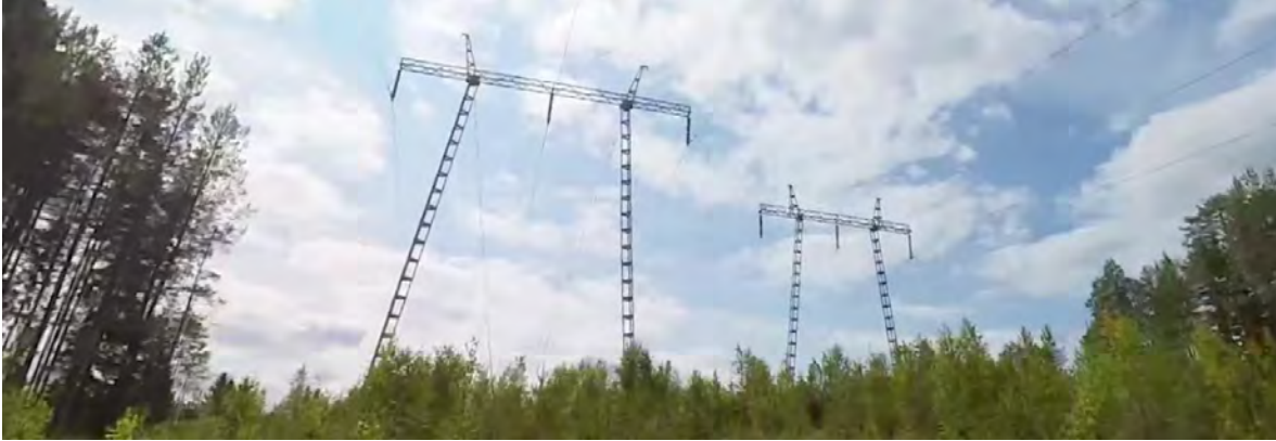
Kuva 6.14 Fingrid Oyj:n kantaverkkoa (Google maps 2023).
