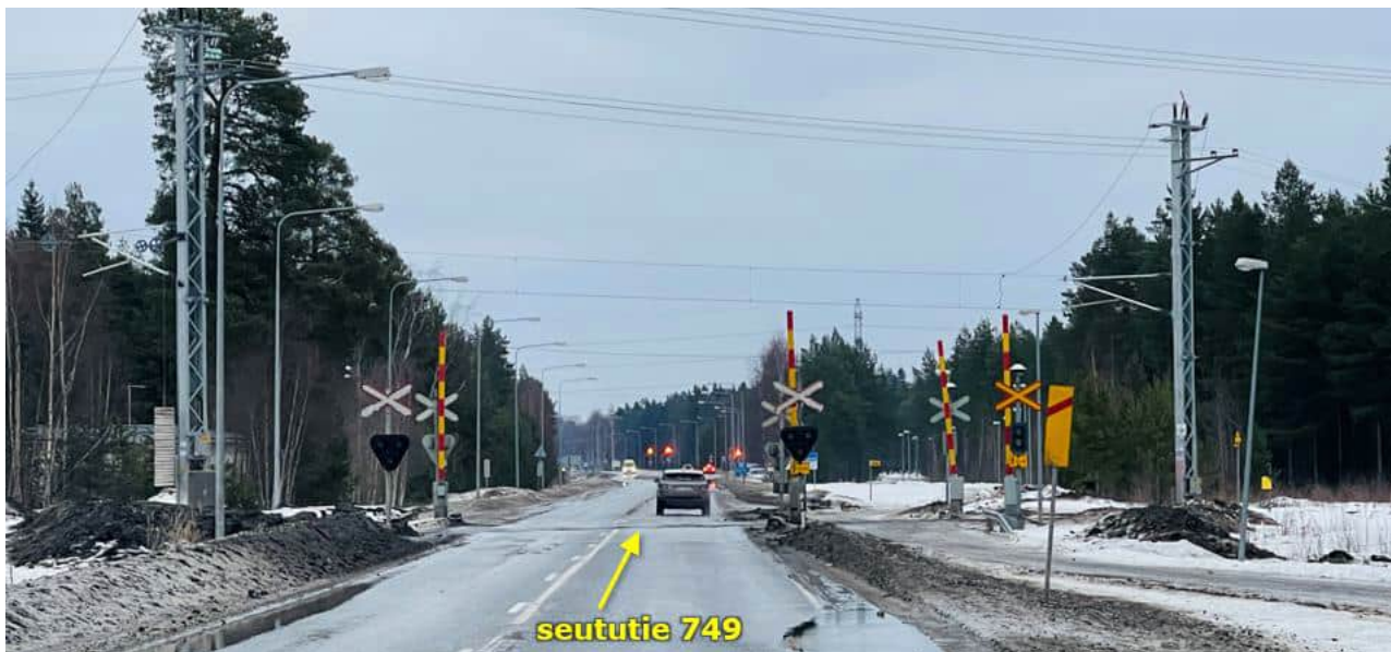
Kuva 11: Kokkolassa seututiellä 749 Varikon tasoristeyksessä on ajojohtimien nostolaitteisto.
