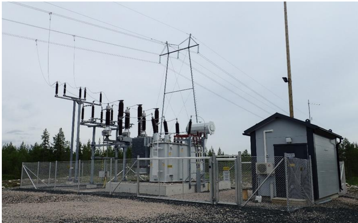
Kuva 95. Esimerkki tuulivoimapuiston pienehköstä noin 30 MW sähköasemasta.
